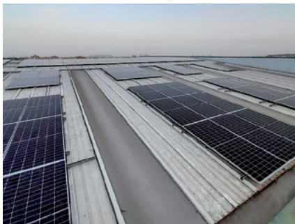
Alimentación Alicante 230 kW
