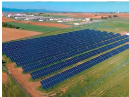
Planta Solar Toledo 1,6 MW
