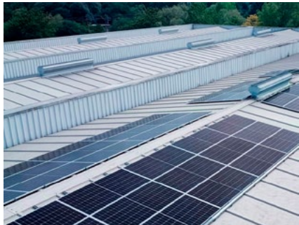
Ferretería Asturias 40 kW
