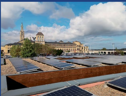
Edificio de oficinas Asturias 50 kW
