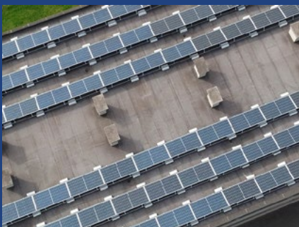
Residencia geriátrica Asturias 50 kW
