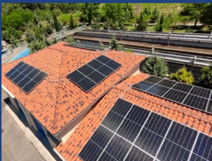
Estación depuradora La Rioja 100 kW
